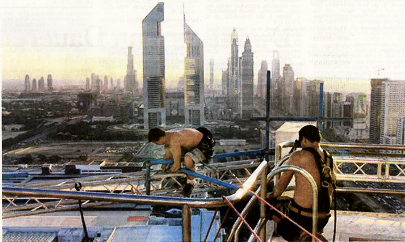
Vor der Kulisse von Dubai bereiten Klettermaxe der Firma Odendahl+Feldbusch ein Gebäude für die Verhüllung vor.
