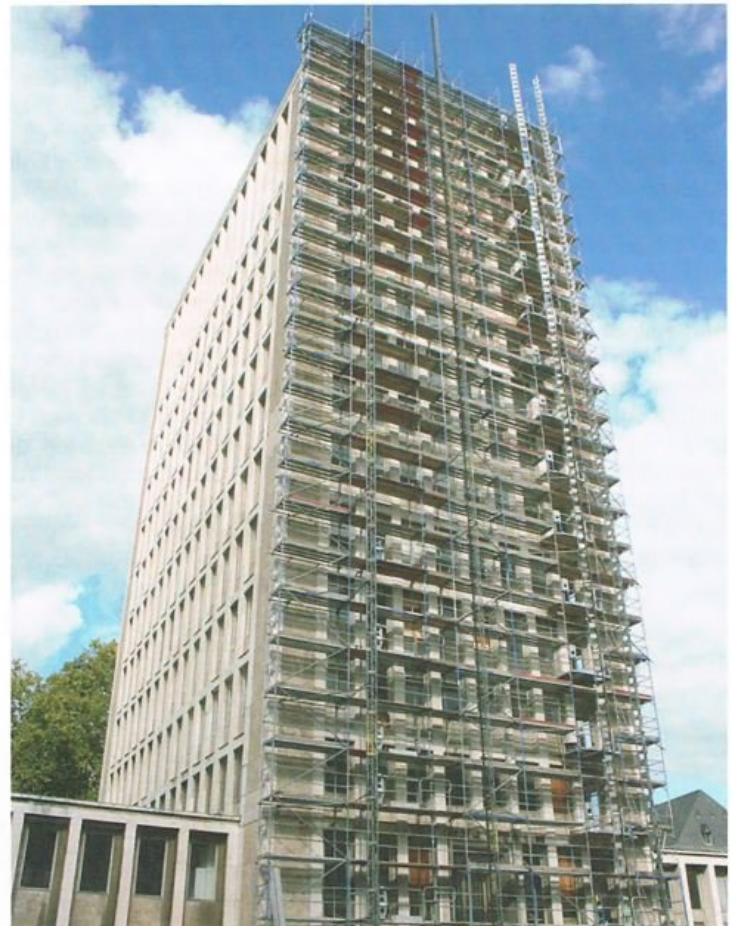
Einrüstung des Gerling-Hochhauses am Gereonshof. Alle Fassaden werden in Abstimmung mit dem Denkmalamt erneuert. Das 14-geschossige Hochhaus des Quartiers bietet einen freien Ausblick auf den Kölner Dom.
